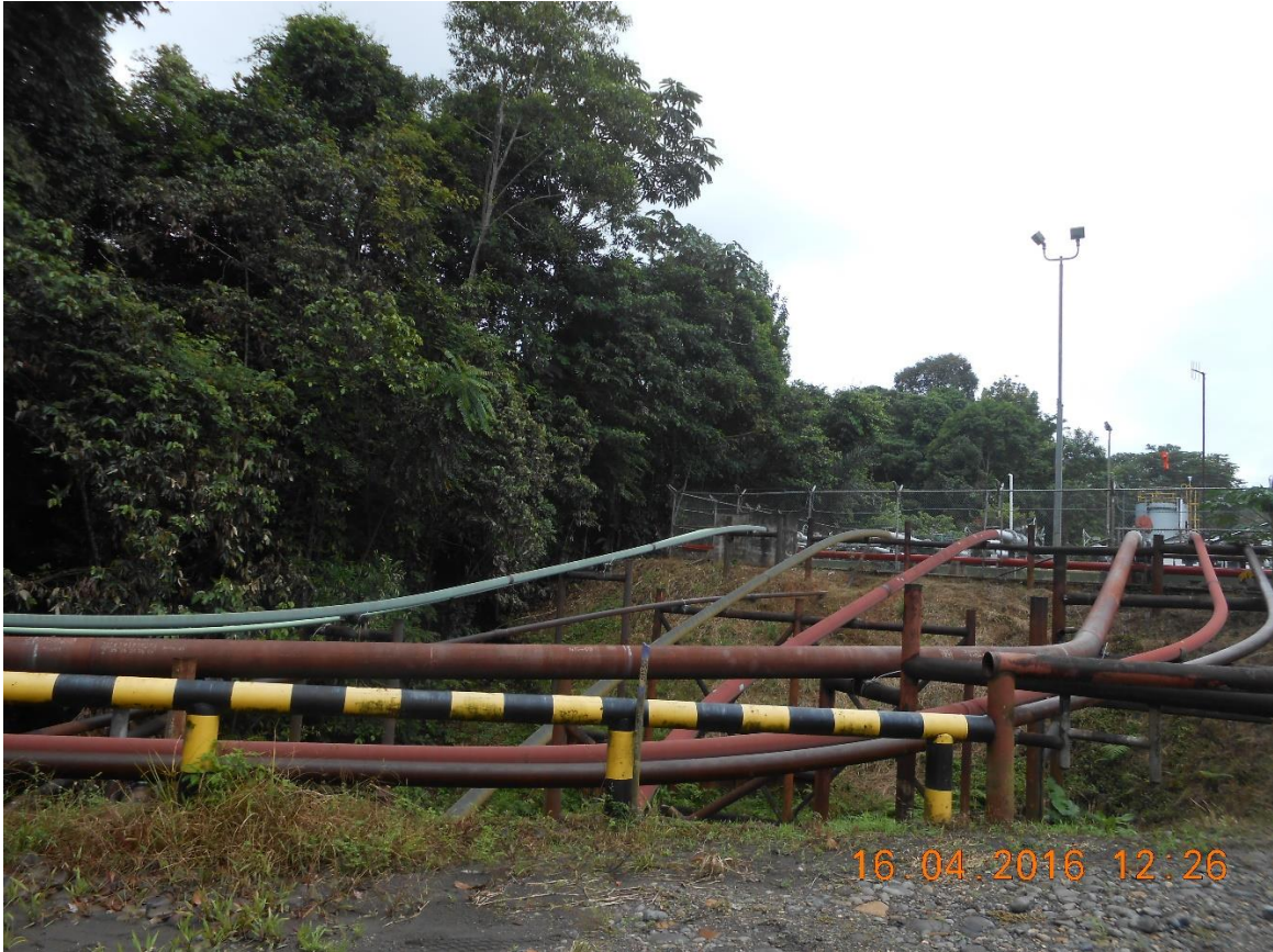
Photo 2 : Tuyaux anciens et nouveaux acheminant des eaux résiduelles de perforation à Dayuma, 2016 (photo prise par l'auteur)
